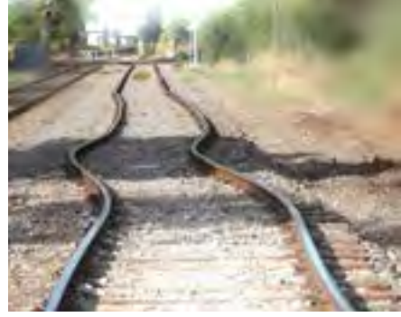
Görsel 4.6. Tren raylarının yaz aylarında sıcaklıkla boylarının uzaması ve bozulması
